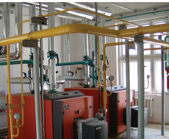
Новое оборудование в 55-й котельной
